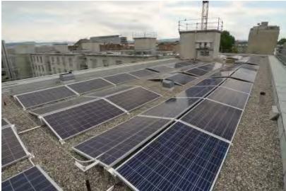
Fotovoltaik auf der Burgfelderstrasse
