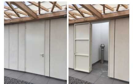
Abstellraum auf dem Dach ohne Dach: Das Behinderten-Wohnheim benötigte für grössere Balkone BGF von uns, die durch Verzicht auf die Überdachung der Abstellräume kompensiert werden konnte.
