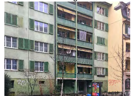
Gebäudehülle mit Sanierungsbedarf
