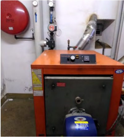
letzte Ölheizung in Waldenburg
