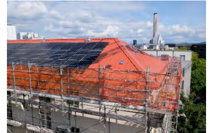
Metалldach mit viel Photovoltaik
